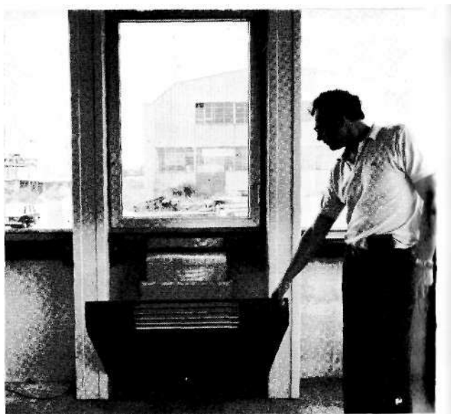
La cubierta del acondicionador de aire
